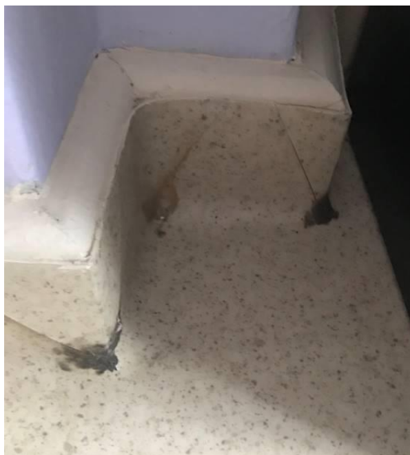
Zdj.4. Poradnia Kliniki Endokrynologii, Diabetologii i Leczenia Izotopami(remont)-gabinet-zawilgocenie posadzek
