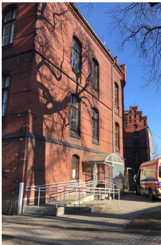
Zdj.5. Na parterze-wejście do aktualnej przychodni, która jest w zakresie remontu. Na II piętrze-przebudowywana Endokrynologia.
